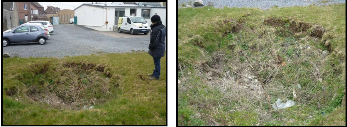
Photographies 3 : Situation du fontis en surface
